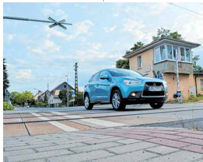
Buckelpiste: Am Bahnübergang in der Lautauer Karl-Liebknecht-Straße muss die Bahn noch einmal nacharbeiten. Foto: Sascha Klein
